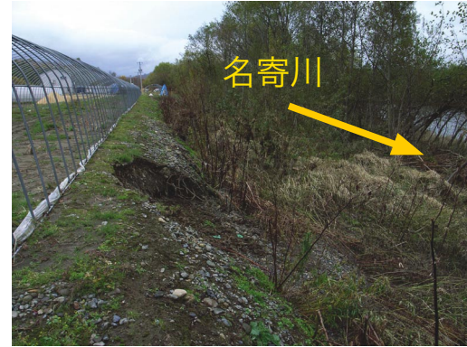
下川町上名寄地区 右岸堤防が未整備のため名寄川の水が氾濫した。川岸の盛土も浸食を受けている。サンルダムを建設しても、整備目標の洪水では浸水を免れられない。早急な対策が必要。
